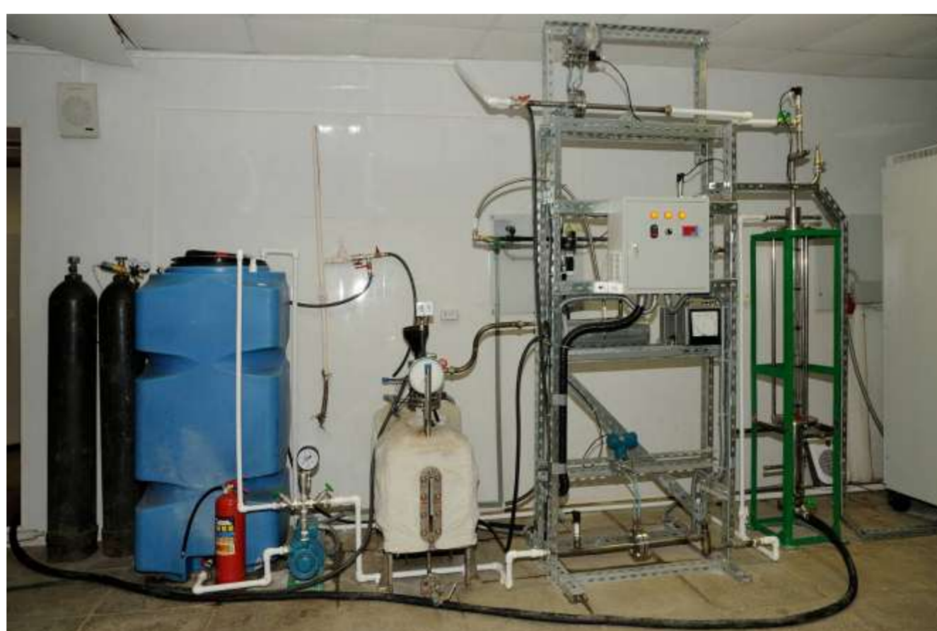
Стенд для испытаний экспериментального образца системы удаления и подготовки к утилизации неконденсирующихся газов
